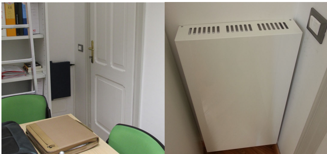
Figura 4 – Server secondario, prima e dopo l'intervento di insonorizzazione.
